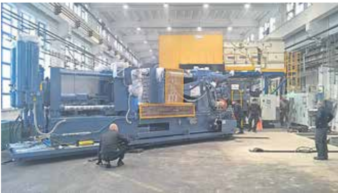
Na začátku listopadu umísťovali technici v hale tlakové slévárny MOTORU JIKOV Slévárna a.s. lící stroj Colosio PFO1000.
