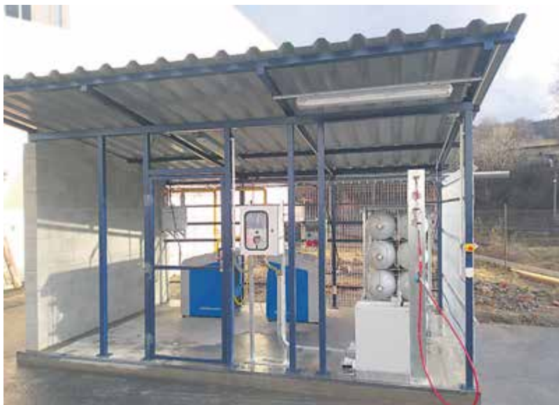
Plnicí stanice MJ Variant 2K-1120-T instalovaná na začátku prosince v České Vsi v sídle společnosti Řetězárna a.s.
